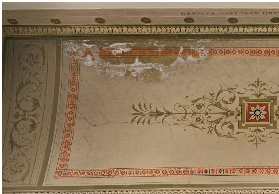
62 Φωτογραφική λεπτομέρεια της οροφής που εικονίζεται στην εικ. 63, στην οποία διακρίνονται, εκτός από τις φθορές λόγω εισροής υδάτων, και ρωγμές στη ζωγραφική διακόσμηση
