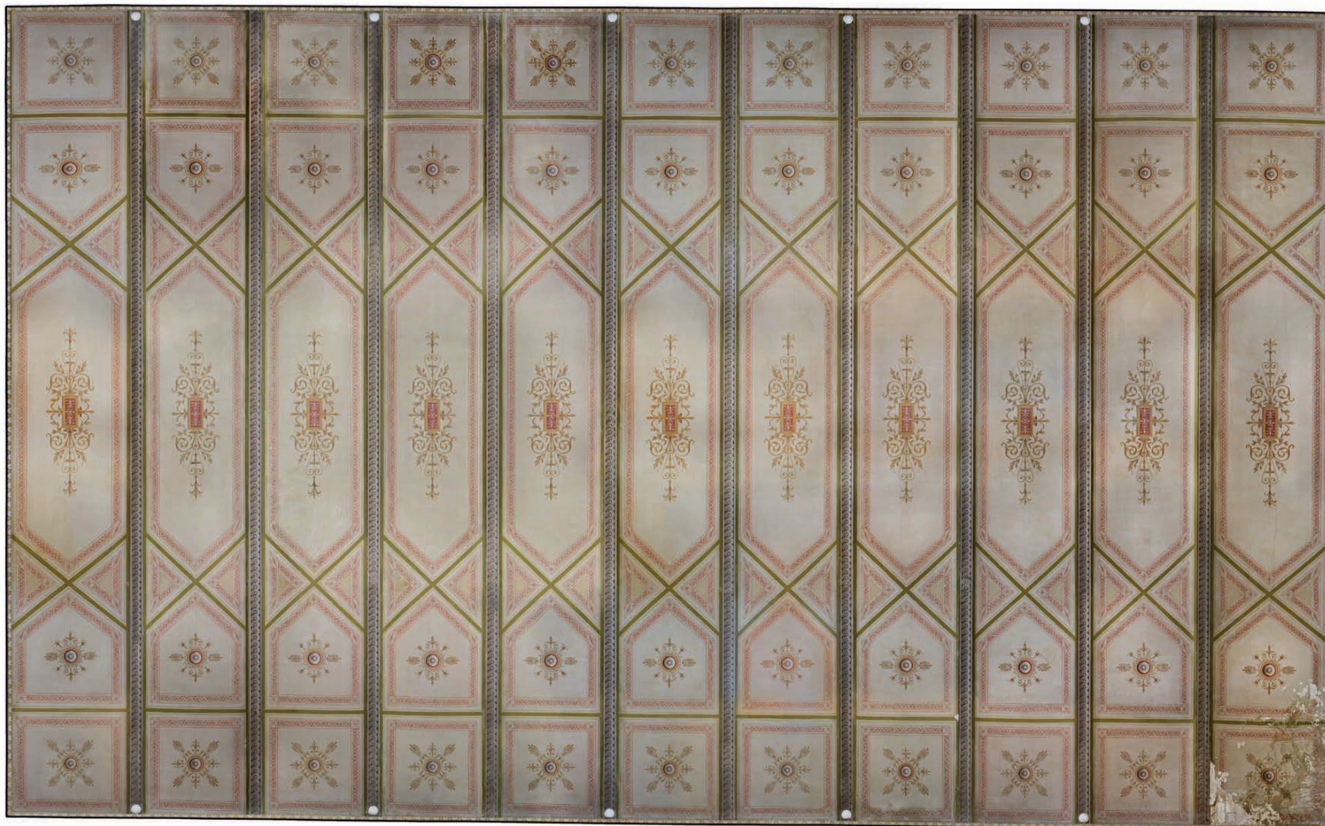
46 Φωτογραμμετρική αποτύπωση της οροφografίας στη Βιβλιοθήκη, 2017. Στην κάτω δεξιά γωνία διακρίνονται καθαρά οι ζημιές από εισροή υδάτων.
